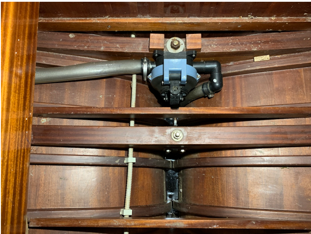
Abb.#23: Zustand Bilge
