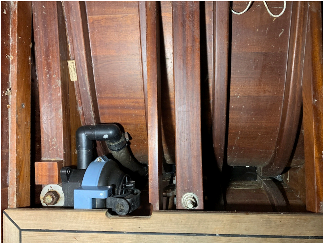
Abb.#22: Bilge und Bilgenpumpe
